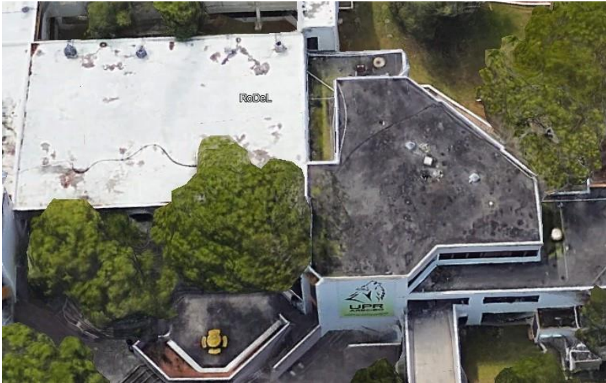
E. Damage #195247; UPR Arcibo Building 033 Almacén de Refrigeración
